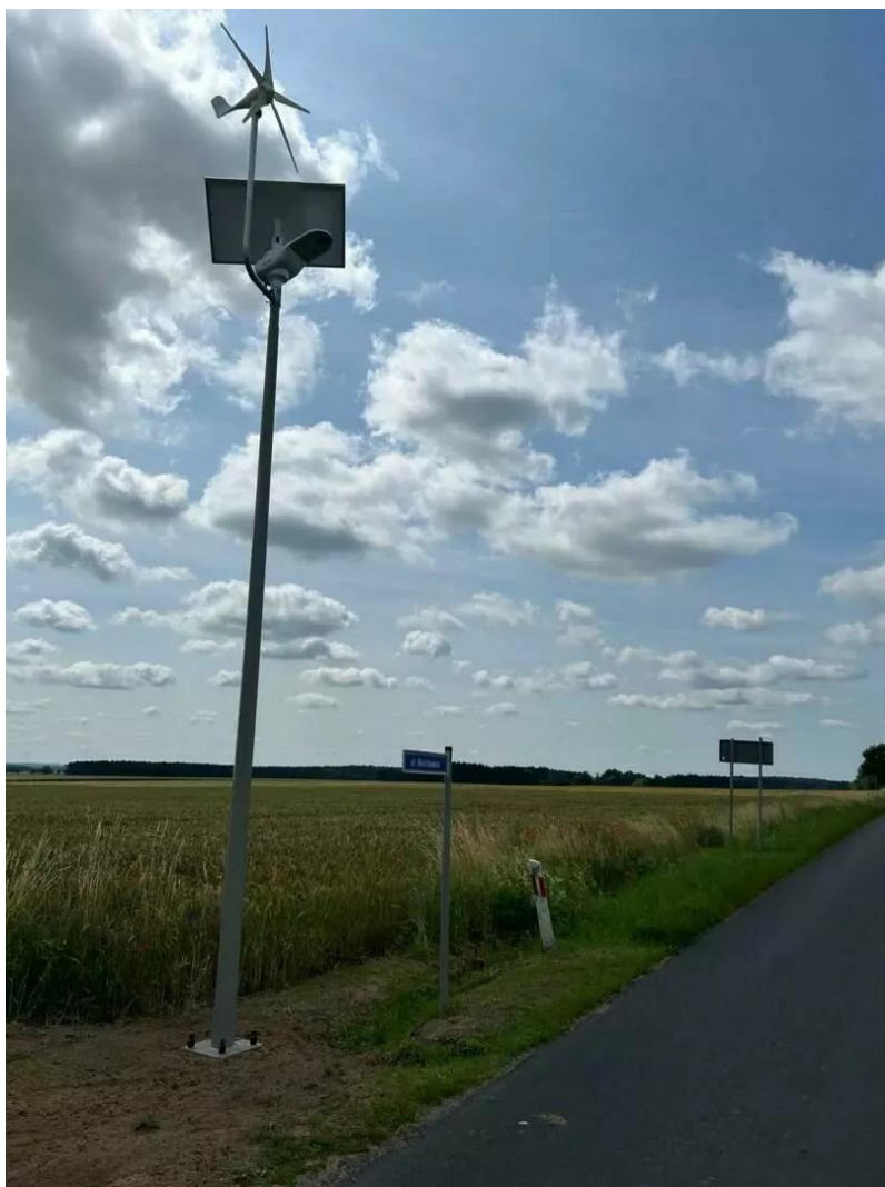
Lampa solarna w Łubnicy
